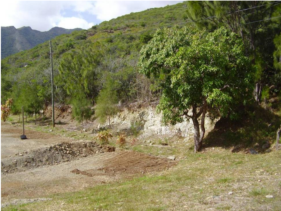
Photo 12 : Talus de terrassement dans des péridotites serpentinisées, collège de Vani, commune de Houaïlou
