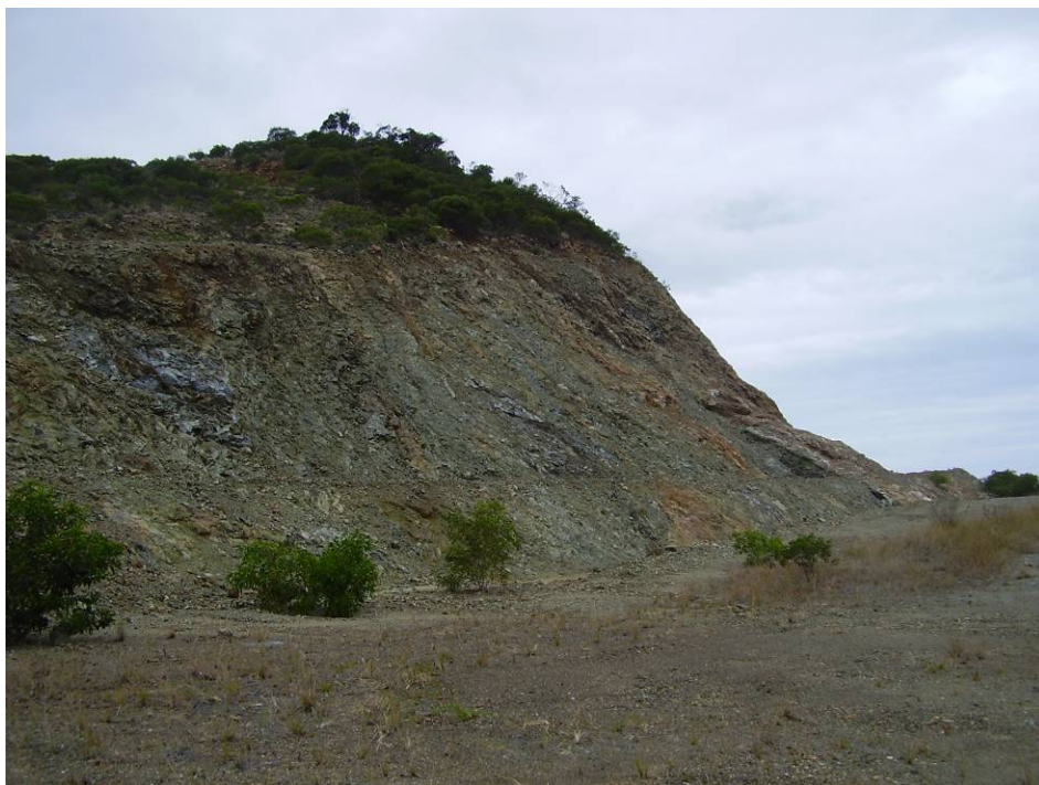
Photo 18 : Talus routier dans des formations de serpentinite, commune de Népoui
