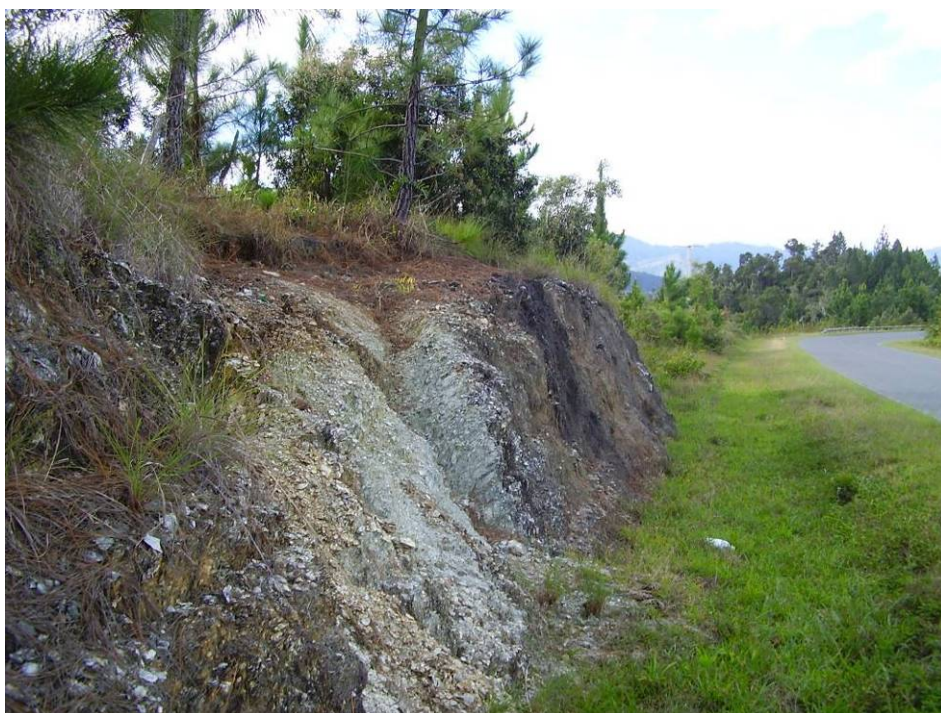
Photo 19 : Talus routier dans une formation de serpentinite fortement altérée en surface et ravinée par les eaux de ruissellement, transversale Koné-Tiwaka
